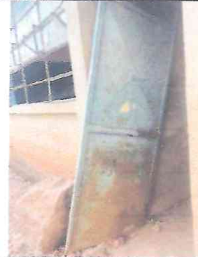
Foto 2: Puerta de cocina dañada por el óxido.
