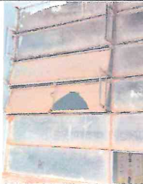
Foto 3: Ventanas quebradas y estructura en mal estado.
